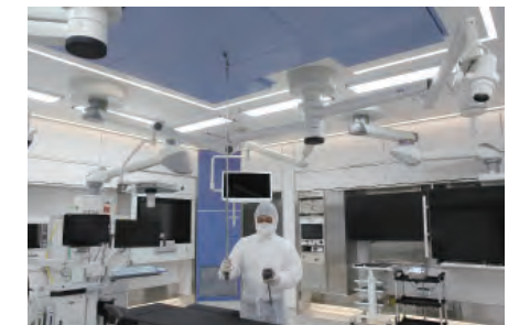
室内循環風速・風量測定
